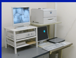
監視システム
