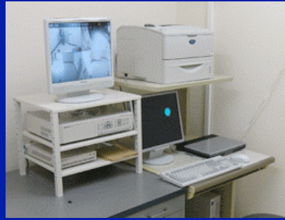
監視システム
